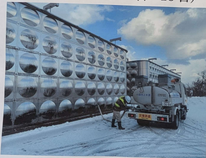
配水池から水の補給を受ける
